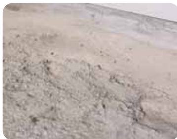
Betonilha de cimento em mau estado
